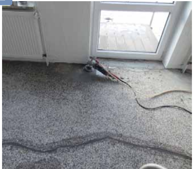
Risse, Fehlstellen und Flecken sind typische Schadensbilder an Terrazzobelägen.
