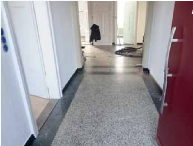
Um die Jahrhundertwende war Terrazzo als Bodenbelag äußerst beliebt. Die Spuren der jahrzehntelangen Nutzung ...
