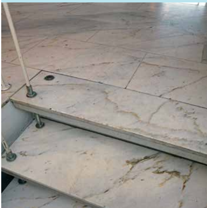
Die Treppe mit unschönen Verschmutzungen und Schäden vor ...
